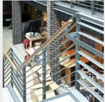
Der Handlauf ist entsprechend DIN 18040 in 85 cm Höhe auf der Innenseite des Geländers angebracht, die Brüstung selber ist höher
