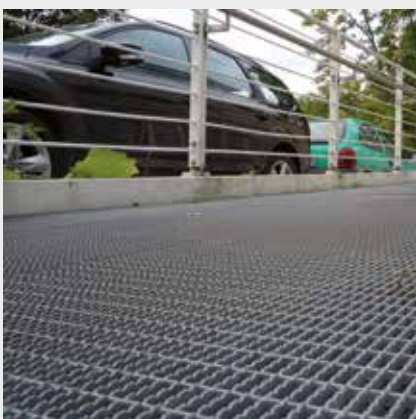
Dieser feinmaschige Gitterrost einer Außenrampe ist auch für Personen mit Gehhilfen geeignet
